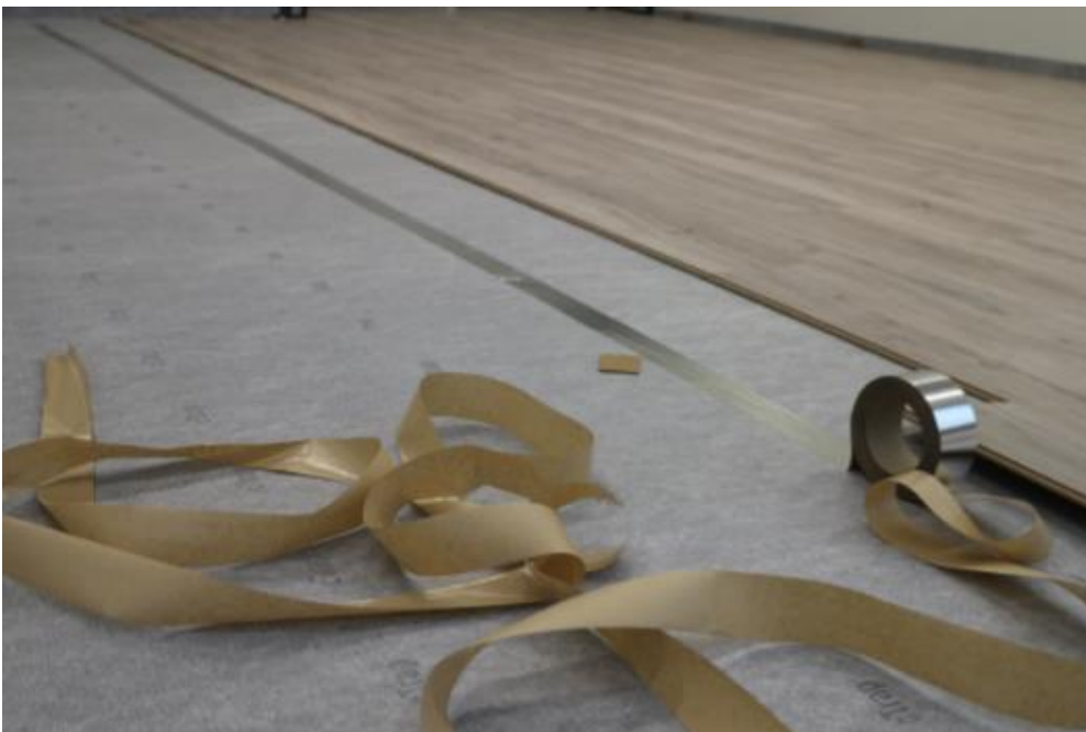
Kuva 4. cTrap tuotteen asennus luokkahuoneessa 1 kesällä 2015
